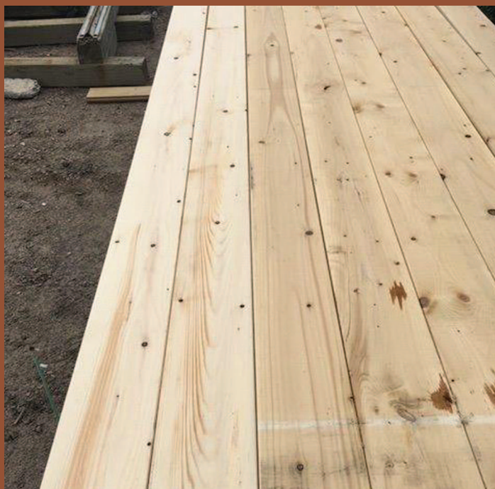
Exemple de bois vieilli sous les intempéries; les 2 pièces de gauche ont été retournées. L'utilisation d'emballage permet de préserver une apparence fraîche du matériel en inventaire
